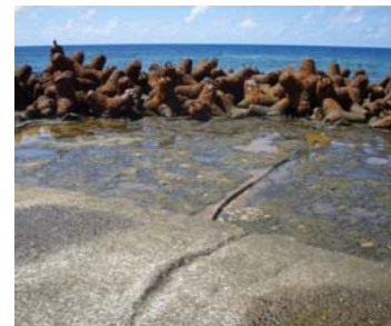
護岸コンクリートの劣化
